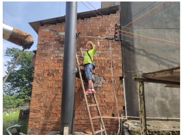
锅炉有组织废气
