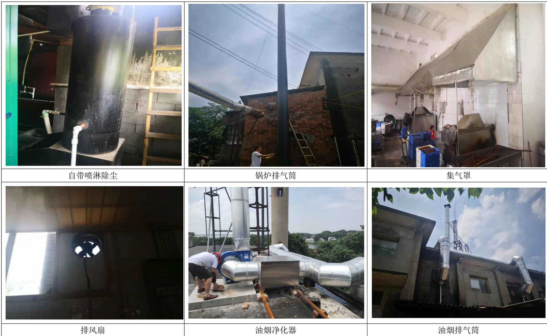
图 4.1-2 项目废气处理设施照片
