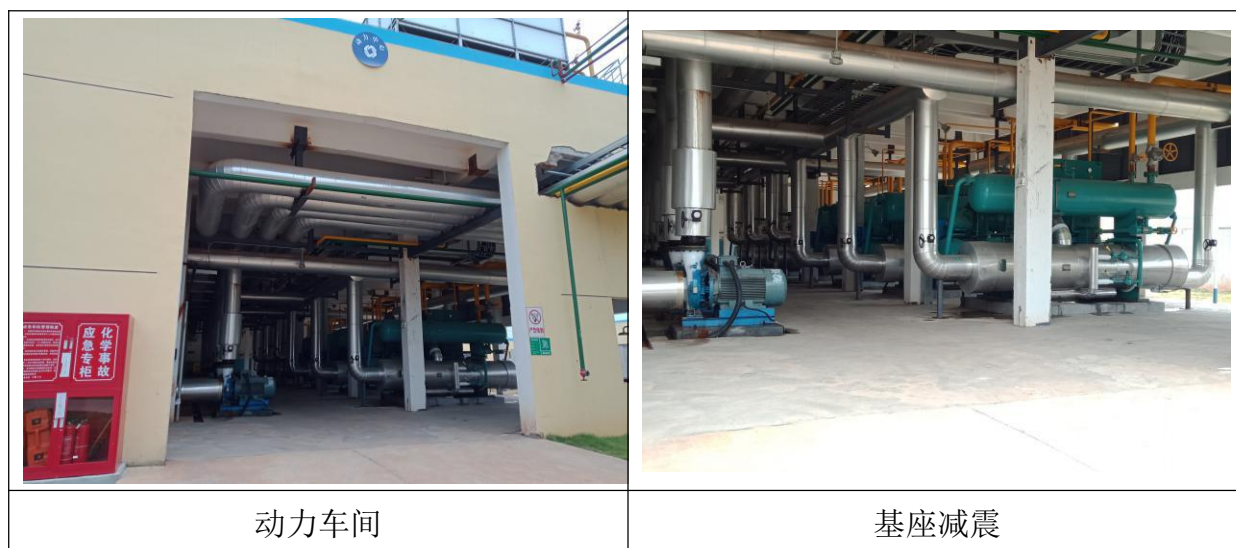
图 4-5 项目噪声处理设施照片
