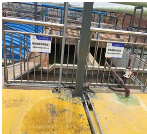
高、低浓度废水收集池
