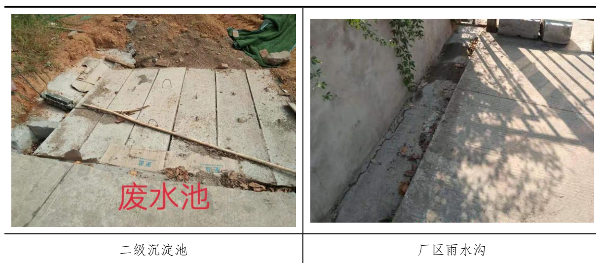
图 4-1 废水处理设施照片
