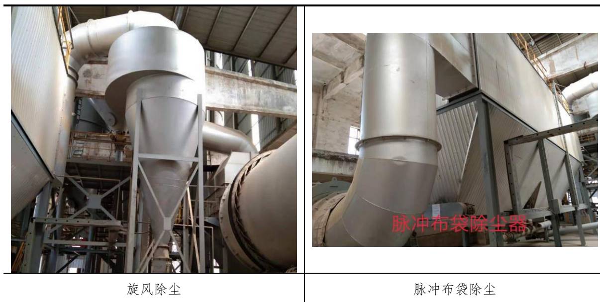
图 4-2 废气处理设施照片
