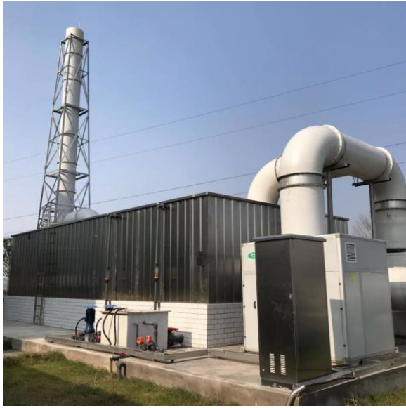
生物除臭装置+15m 高排气筒
