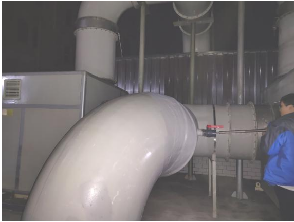
废气处理设施进口采样点
