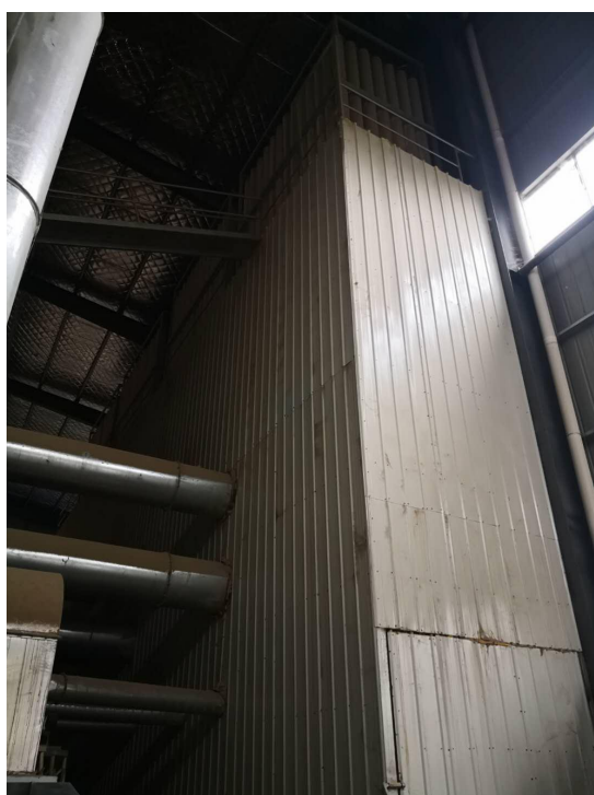
沉降室+布袋除尘器
