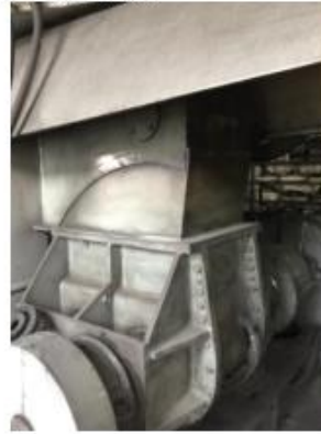
4. 配炼车间—混料设备 2
