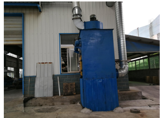
配炼车间布袋除尘
