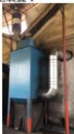
1. 配炼车间—除尘装置 1
