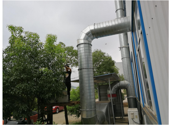
硫化车间排气筒进口监测
