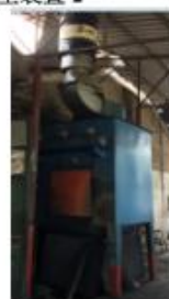
2. 配炼车间—除尘装置 2
