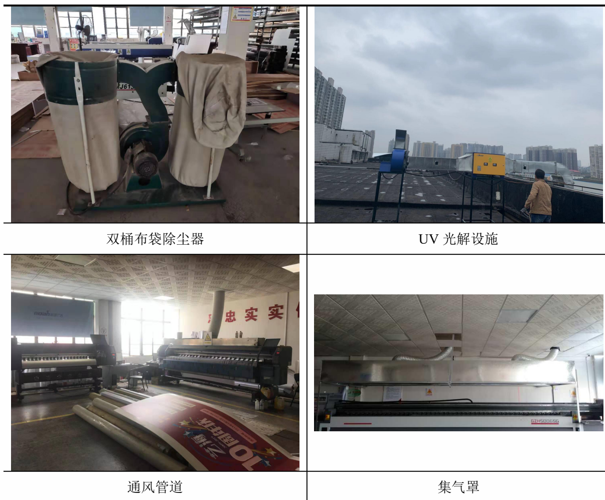
图 4-1 废气处理设施照片
