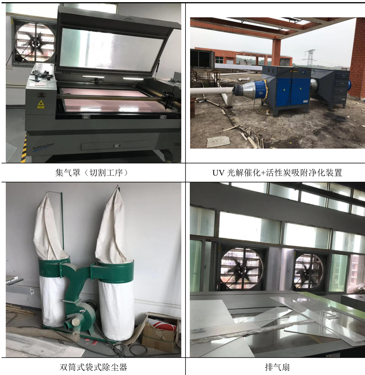
图 4-2 废气处理设施照片
