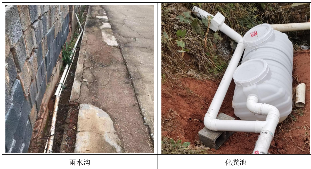
图 4-2 废水处理设施照片
