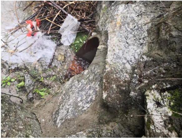
生态流量放水管
