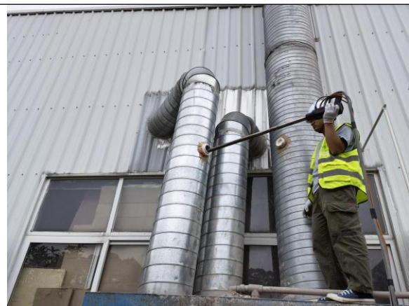
固化废气处理设施进口 1
