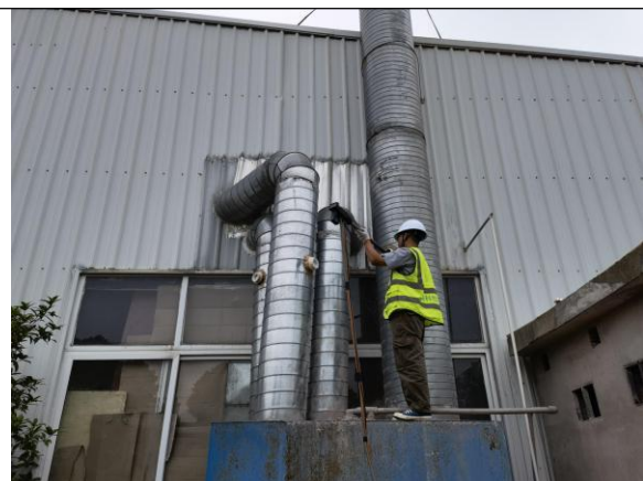
固化废气处理设施出口
