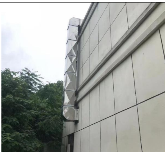
食堂油烟排气筒
