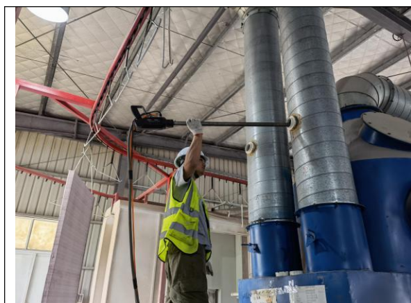
喷粉废气处理设施进口 1
