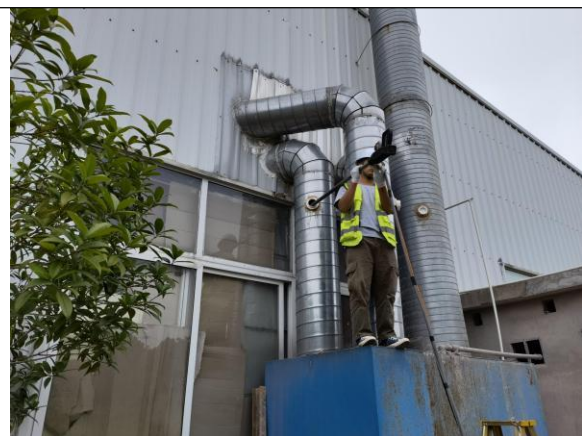
固化废气处理设施进口 2
