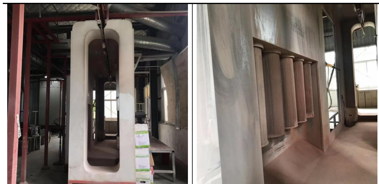
喷粉废气滤筒除尘器
